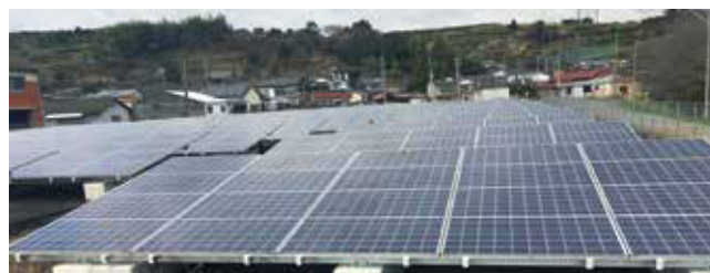
太陽光パネル
