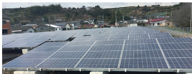
太陽光パネル
